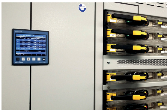
04 Netzanalysator UMG 508 von Janitza für den Fronttafel-einbau im Einsatz
