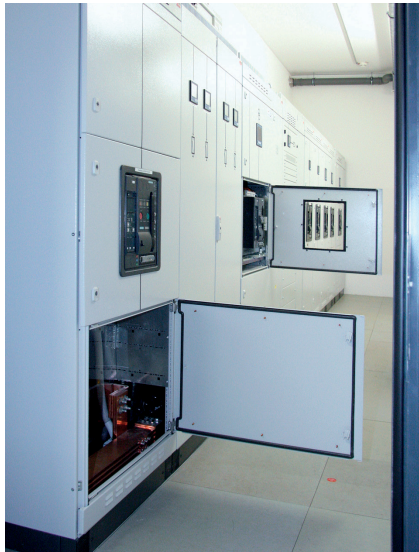
03 Niederspannungshauptverteilung mit offener Tür
